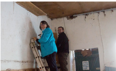
Mario und Birte bauen in der Diele Bretter unter die zahlreichen Schwalbennester, damit die Vögel demnächst nicht auf das Gemüse schieteren
